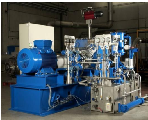
Рис. 1. Мини-ТЭЦ работающая на древесных отходах
